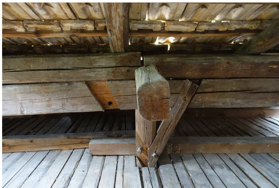
Abb. 25: Doppelte südliche Mittelpfette, die obere in Höhe der Flurwand-Ost gestoßen; der Binderbalken ist hier nachträglich gekappt.
